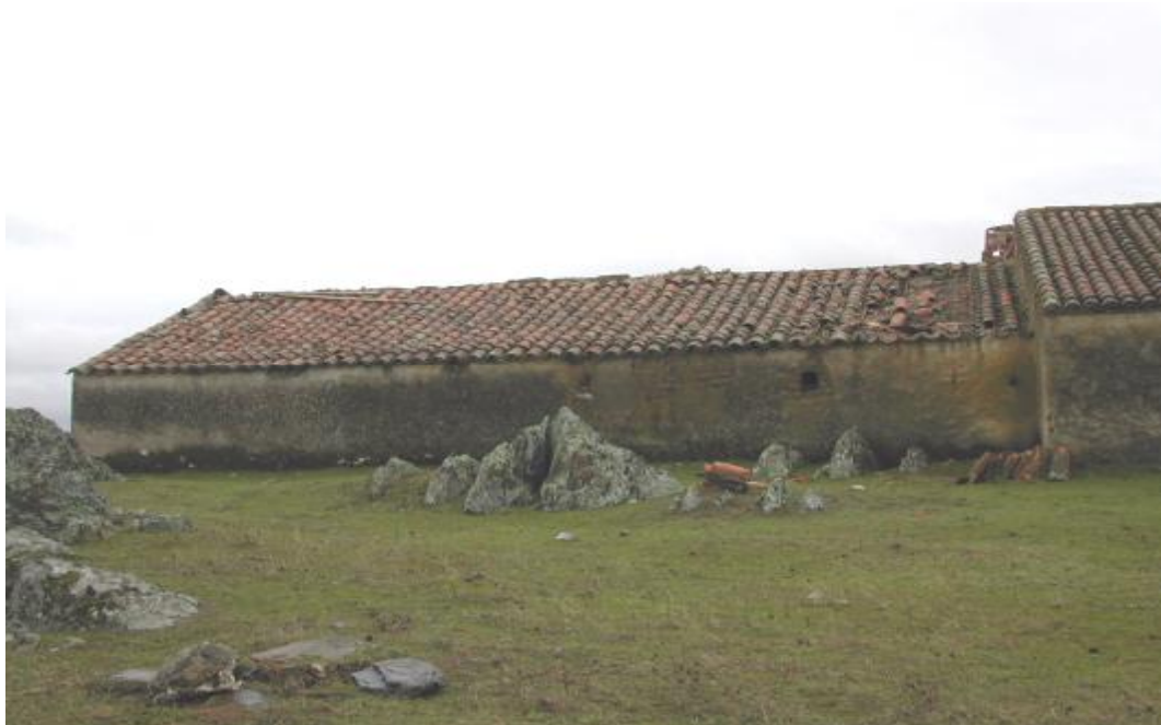
Foto nº 1: Estado de la colonia de Cernícalo primilla en la cubierta de “Villaralto” antes de la rehabilitación.
