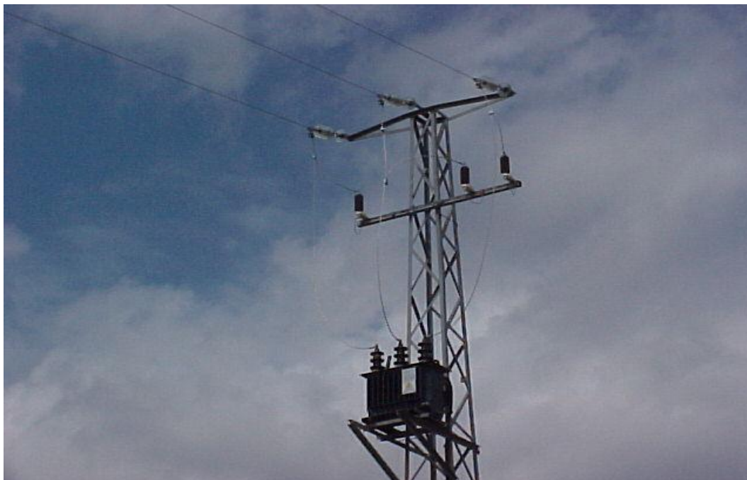
Foto n° 4: Apoyo con Centro de Transformación a intemperie.
