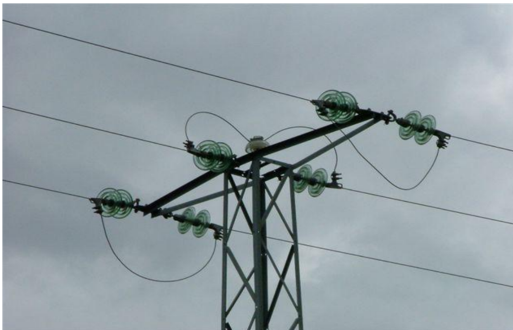
Foto n° 3: Apoyo de celosía con cruceta de amarre y un aislador rígido.
