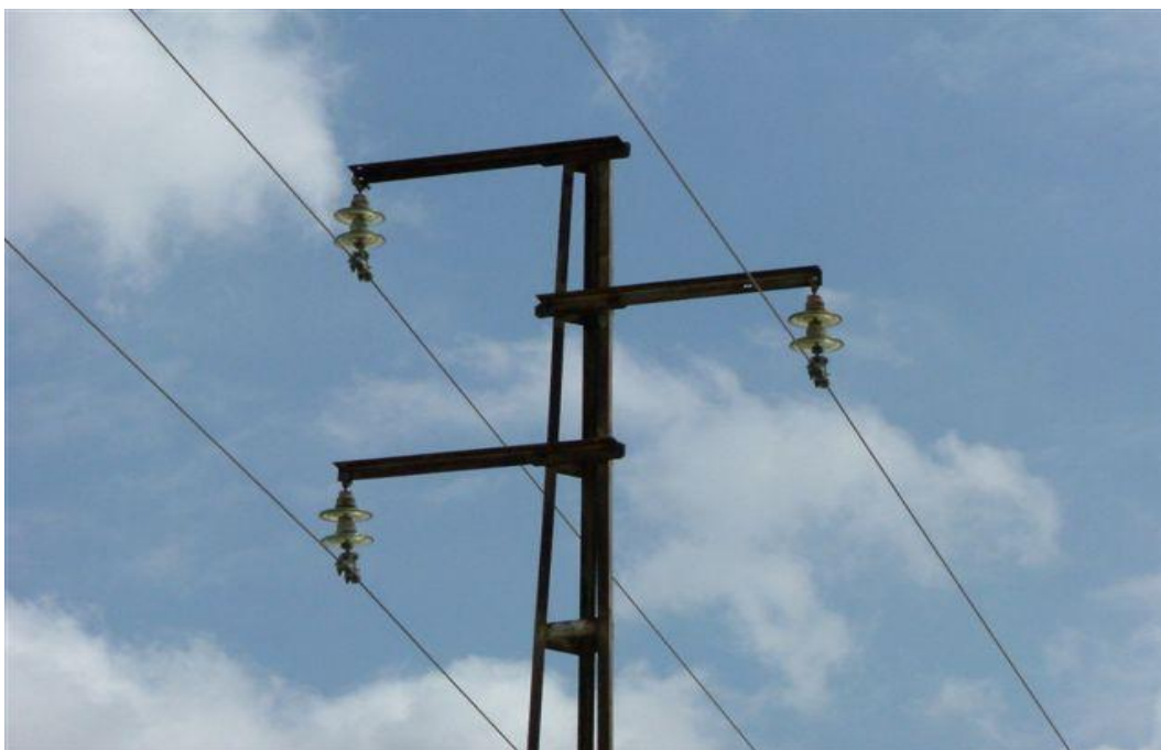
Foto n° 2: Apoyo de alineación con cruceta al tresbolillo con dos aisladores U40 por fase.
