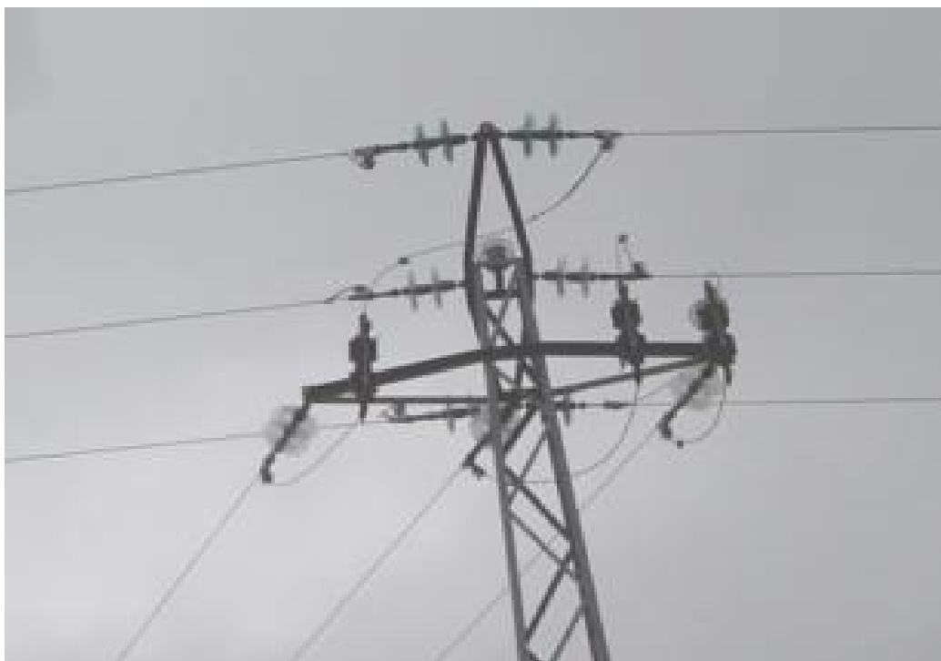
Foto n° 5: Apoyo de amarre con cruceta de derivación
